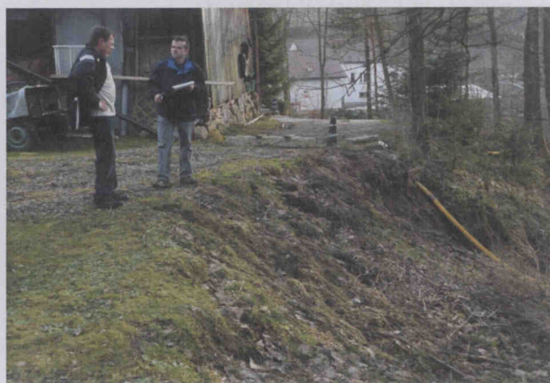
Fot. 6. Świeży obryw w obrębie czoła osuwiska poniżej zagrożonego budynku gospodarczego (widoczne rury drenarskie, odprowadzające wody z terenu posesji).
