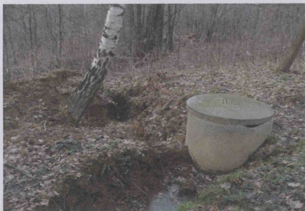
Fot. 3. Zagrożona studnia w części aktywnej osuwiska.
