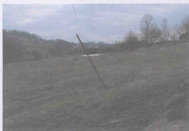
Fot. 5. Zdenudowana powierzchnia osuwiska oraz przechylony słup linii telefonicznej w części okresowo aktywnej osuwiska.
