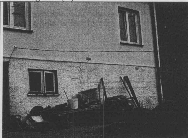
Spękane fundamenty i ściany budynku Cergowa nr 203
