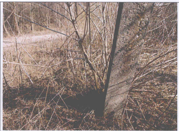
Zagrożona linia elektryczna tuż powyżej skarpy osuwiska
