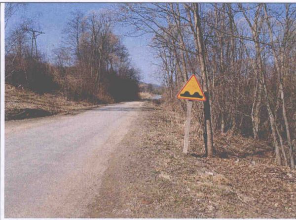
Widok na niszczony odcinek drogi powiatowej od wschodu
