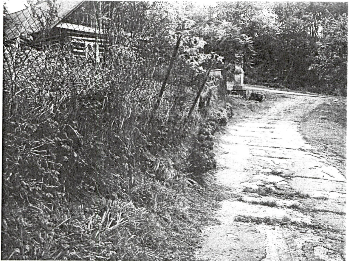
Fot. 3. Czoło osuwiska niszczące ogrodzenie.
